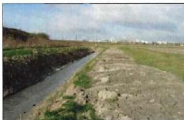
Dépôts de matériaux de curage sur la servitude d'entretien du Watergang du sud - vue le long de l'A16
